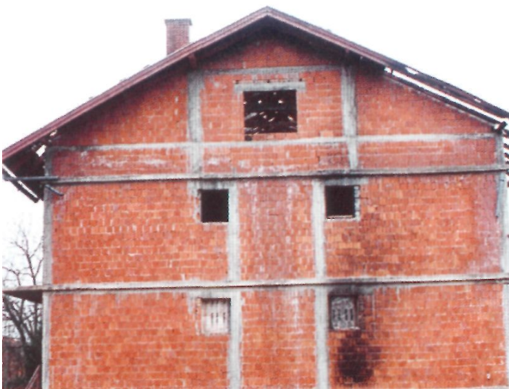
Spaljena župna kuća
