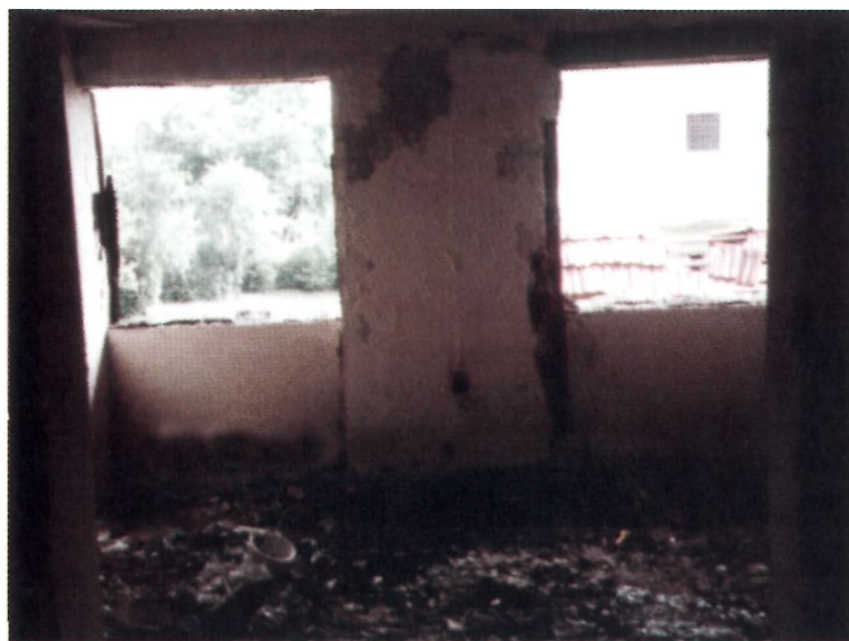
Unutrašnjost spaljene župne kuće
