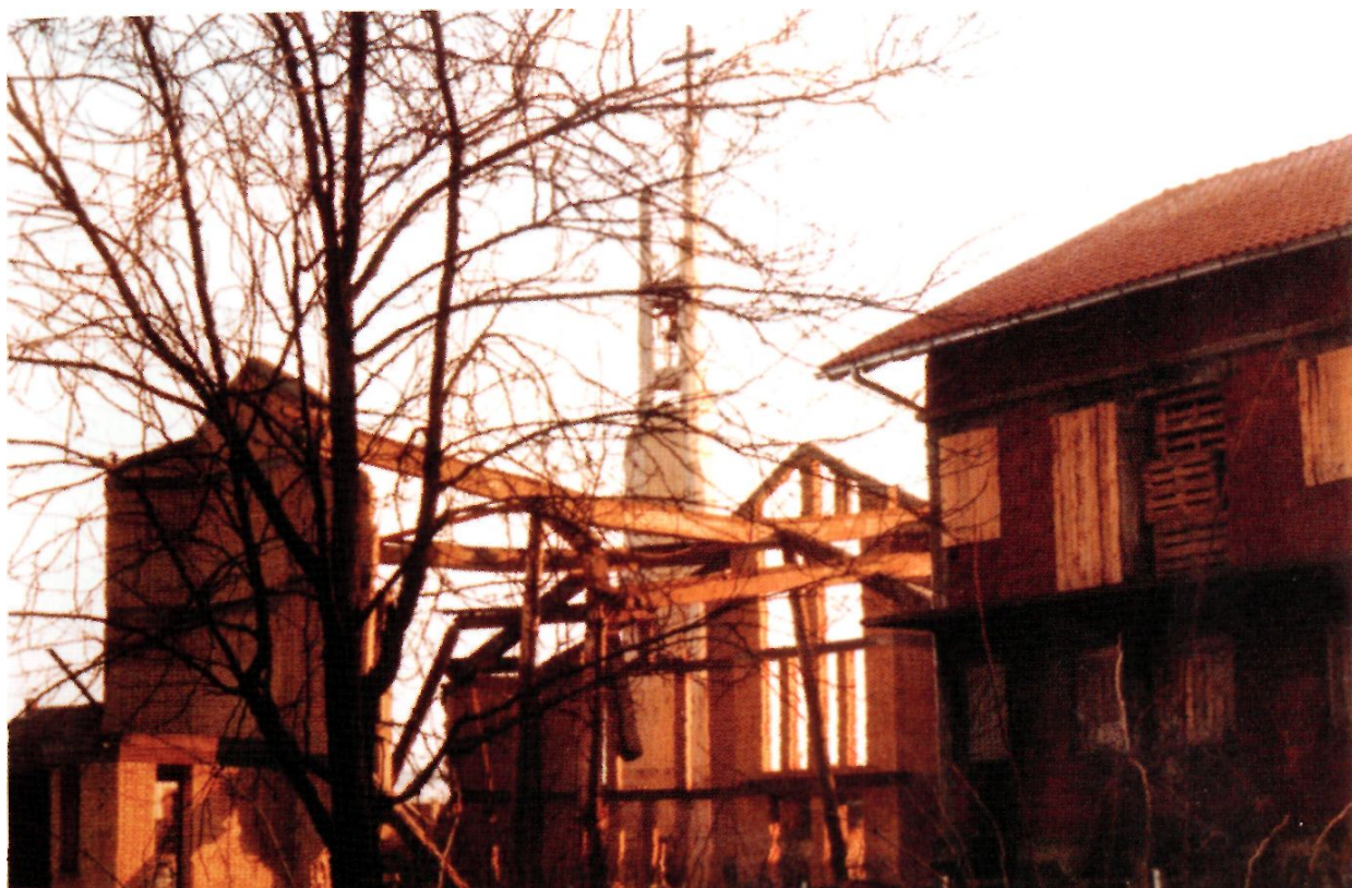
Spaljena kuća zakovana je do obnove da dalje ne propada
