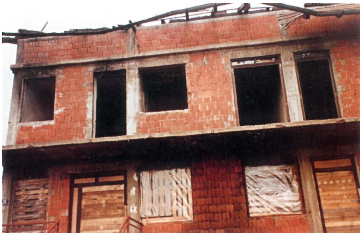
Još jedan pogled na spaljenu župnu kuću
